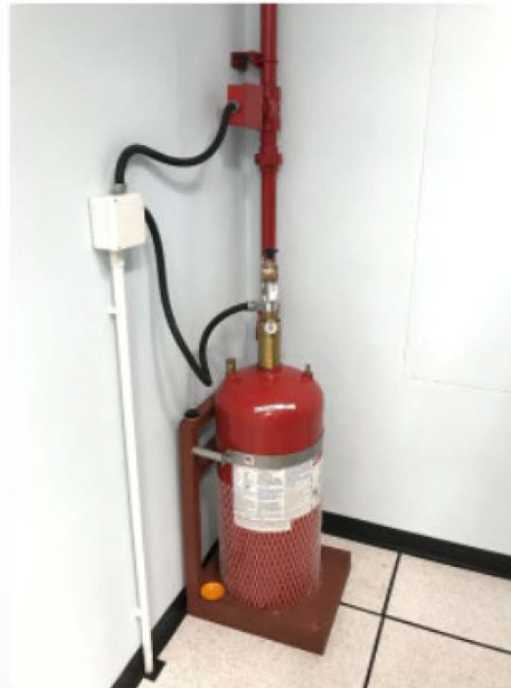
ถังสารเคมีดับเพลิง
