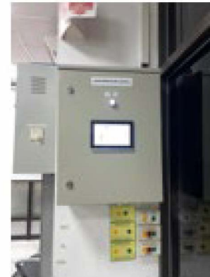
PLC ควบคุมแอร์
