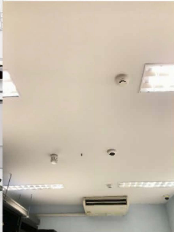
ระบบตรวจจับควัน
